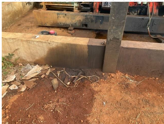
Figura 11: Caixa de contenção do conjunto motor-bomba com sinais de vazamento de óleo.
