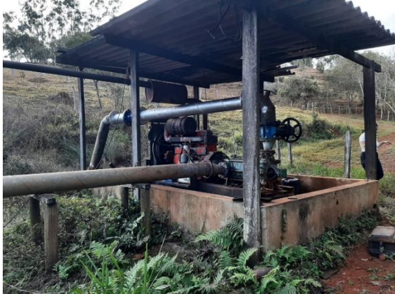
Figura 08: Sistema de motor-bomba para bombeamento de água para irrigação.
