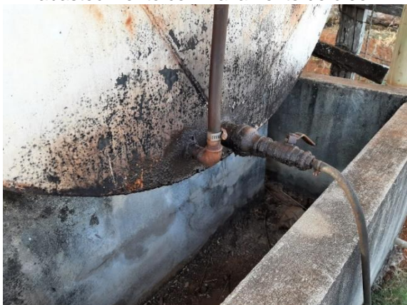
Figura 10: Caixa de contenção do ponto de abastecimento com vazamento de óleo.
